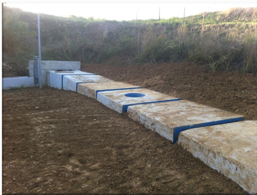
Ripartitore di portata e raccordo con la rete preesistente
